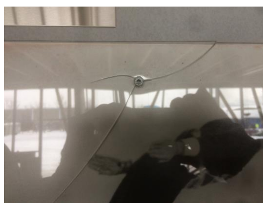
Sprekker i glasset fra skruen.
