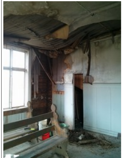
Vattenskada i kyrksalen
