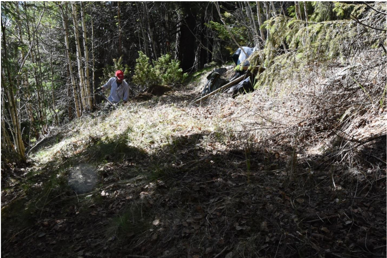
Figur 6. Profilschakt dras vinkelrätt genom Vibyggerå 211 bruksväg/stig. Resterande delar av den mot söder (vänster) utrasade vägbanken syns tydligt. Strax bakom enbärsriset övergår vägbanken till att vara en stig.
